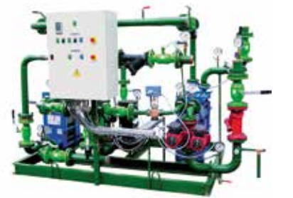
Блочный индивидуальный тепловой пункт (БИТП).
